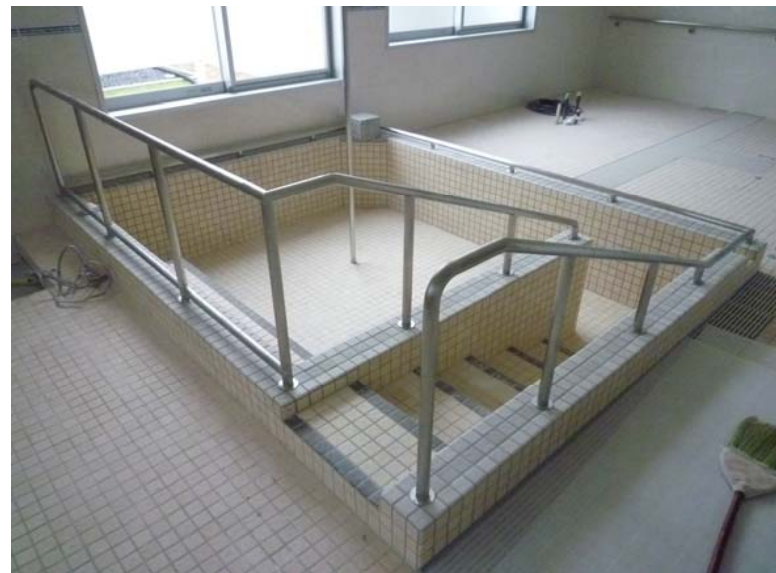
一般浴室 浴槽
