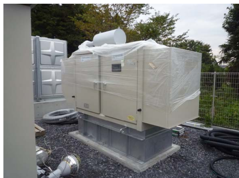
非常用発電機
